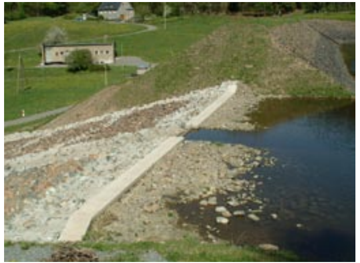
Zusätzliche eingebaute provisorische Hochwasserentlastung zur Gefahrenabwehr
